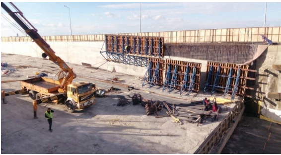
Mustafa Kemal Sahil Bulvarı Küçükyalı İle Karataş Arası Güzergahta Altyapı ve Sanat Yapıları
