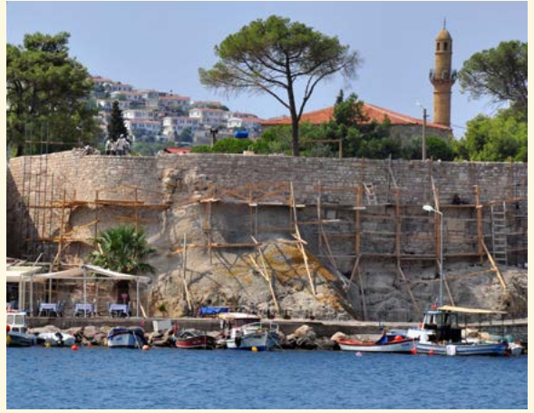
Athena Tapınağı'nın bulunduğu kayalık tepeyi çeviren Ceneviz Dönemi kent duvarı restorasyonunda genel bir görünüm.
